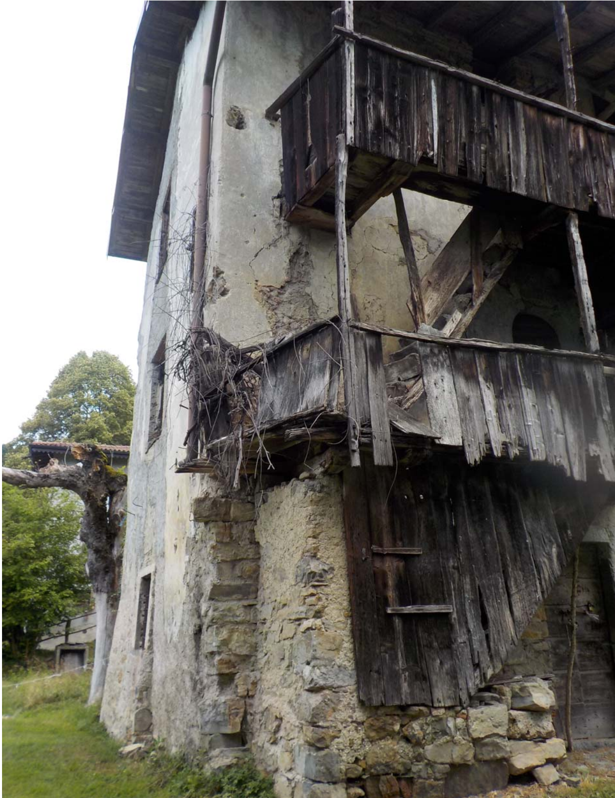
Les vieux balcons de bois croulent. Qui les remontera ?
